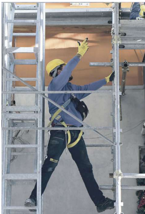
Al lavoro in un cantiere edile di Napoli: la previsione del Fondo Complementare ha consentito la proroga della misura del 110%. NewFotoSud R.Esposito
